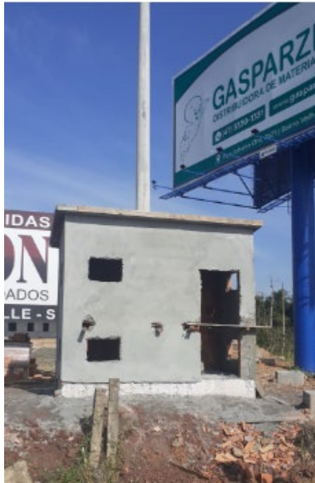
Figura 30 – Casa de energia elétrica
