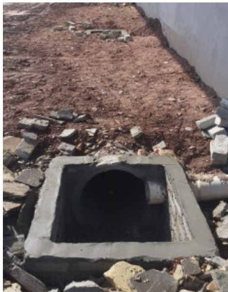
Figura 32 - Galerias de drenagem do empreendimento
